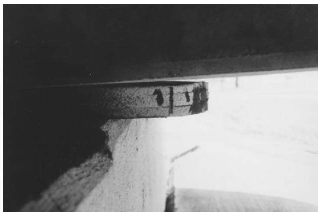
รูปที่ 2.2-4 การเลื่อนไถลของยางรองคอสสะพาน
